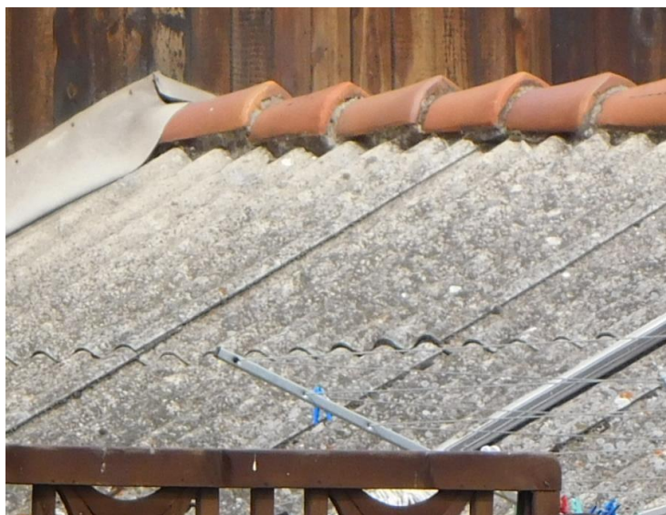
Fot. 1 Płyty azbestowo-cementowa stosowane w budownictwie Źródło: Internet
